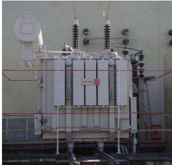
Figura 2.3: Transformador monofásico de curto-circuito com potência de curto de 350 MVA
