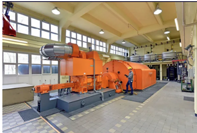
Figura 2.11: Gerador de curto circuito com sistema AVR e motor de indução com conversor de frequência
