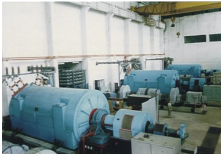
Figura 2.8: Gerador de curto circuito fabricado pela Electrosila
