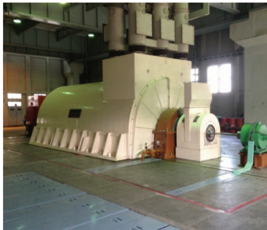
Figura 2.10: Gerador de curto circuito com partida estática
