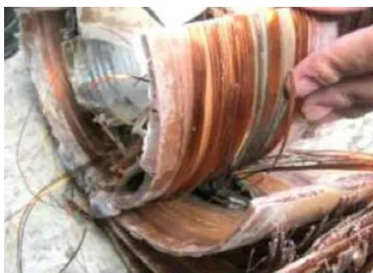
Figura 16 – Efeitos da ferrorressonância nos enrolamentos primários do transformador de tensão (AKTIF, 2021).
