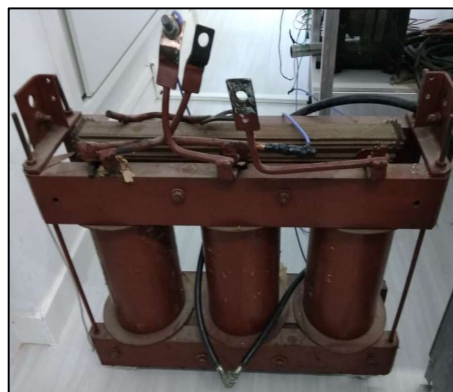
Figura 43 - Transformador de 75 kVA utilizado nos ensaios. FONTE: Elaboração Própria.
