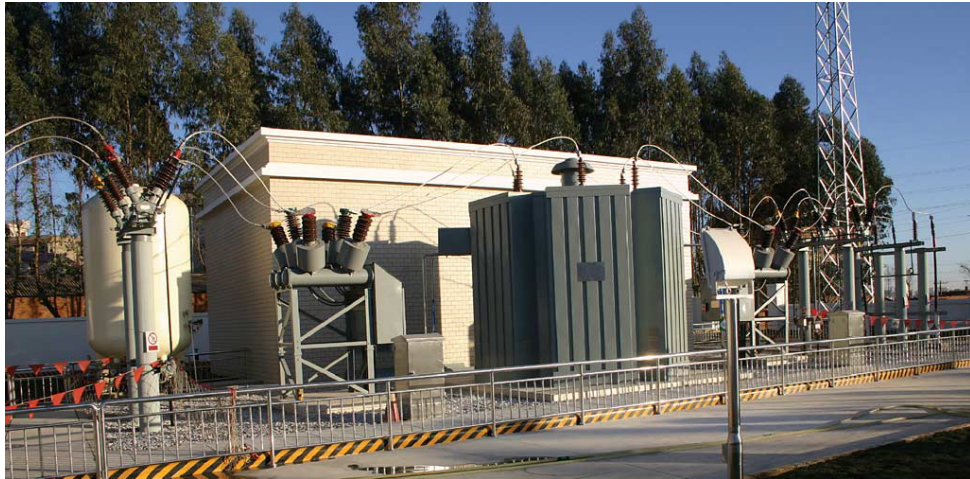
Figura 2.4: Protótipo de LCCS-NS de 35 kV instalado pela Innopower na China.
