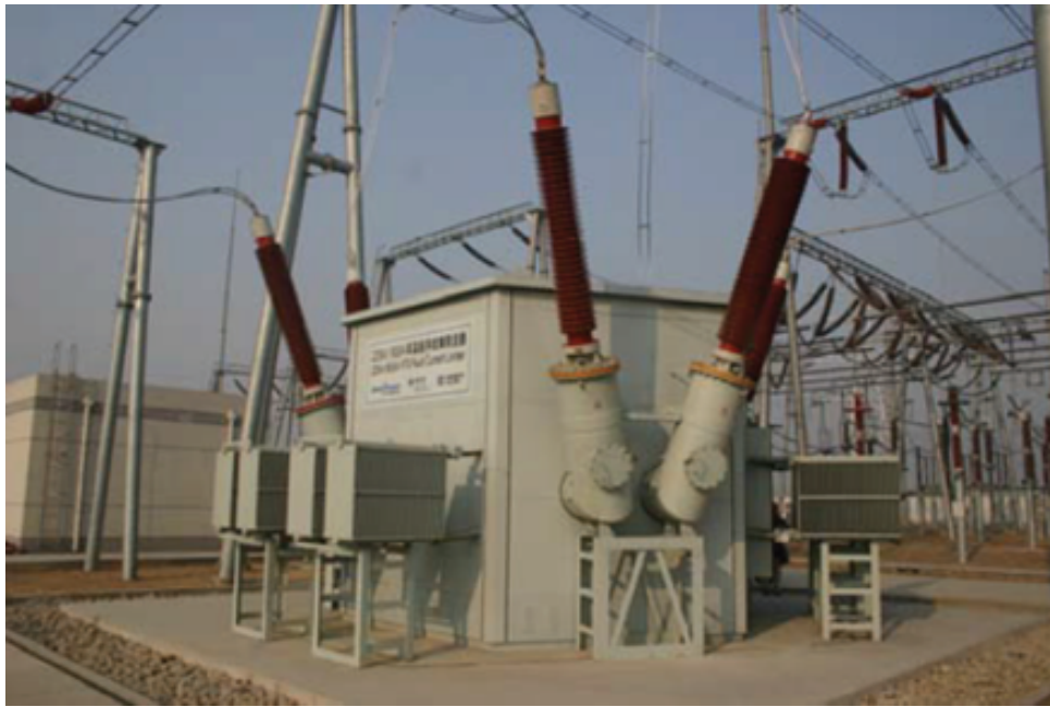
Figura 2.5: Protótipo de LCCS-NS de 220 kV instalado pela Innopower na subestação de Shigezhuang em Tianjin, China.
