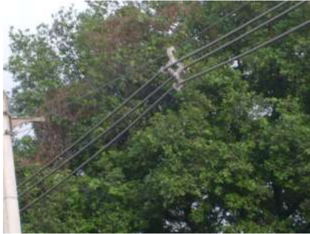
Figura 6 – Linha compacta de média tensão
