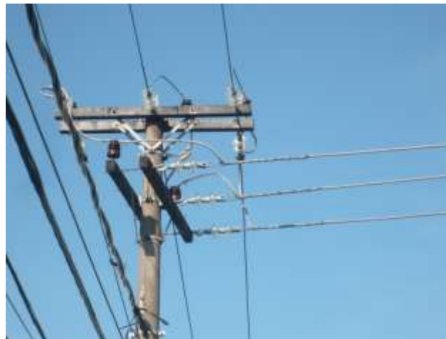
Figura 5 - Linha convencional de média tensão
