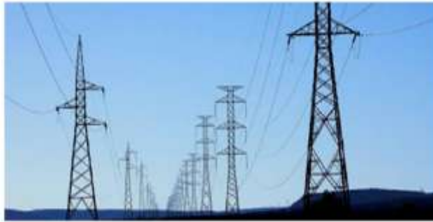
Figura 10 - Trecho de uma linha de transmissão
