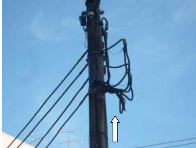
Figura 9 – Descida para linha subterrânea de baixa tensão
