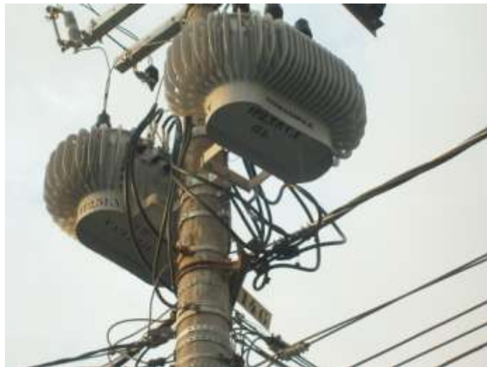
Figura 15 – Linhas de MT e BT instaladas no mesmo poste :
